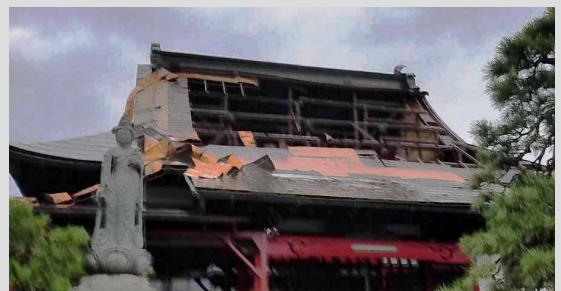
(市原市:円頓寺本堂屋根損傷)
